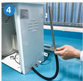
将透明气管套进波纹管内，在连接进气口，管子尾部连接采样管，把采样管插进烟道里
